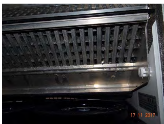
Abbildung 45: WNG ID 210: Wärmetauscher
