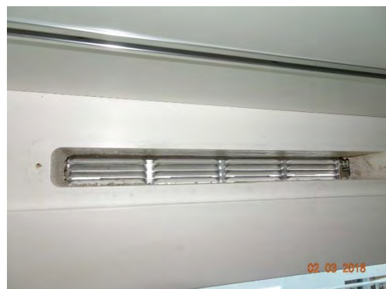
Abbildung 168: WNG ID 730: Durchbruch AUL v.I.
