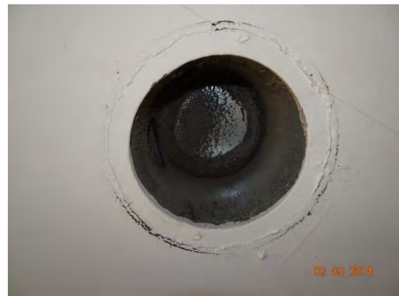
Abbildung 179: WNG ID 730: ABL-Rohr, Bad
