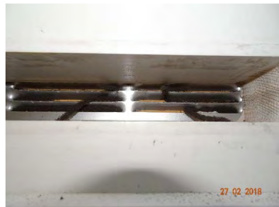
Abbildung 157: WNG ID 720: Durchbruch AUL v.I.
