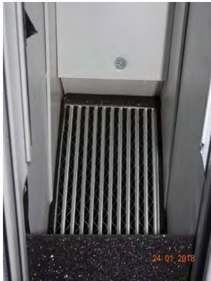
Abbildung 140: WNG ID 620: Wärmetauscher
