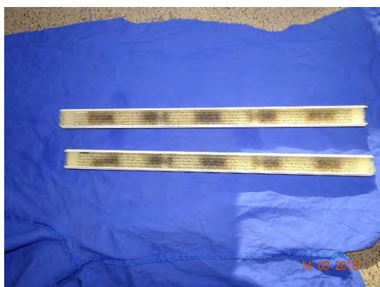
Abbildung 199: WNG ID 830: Zuluftfilter
