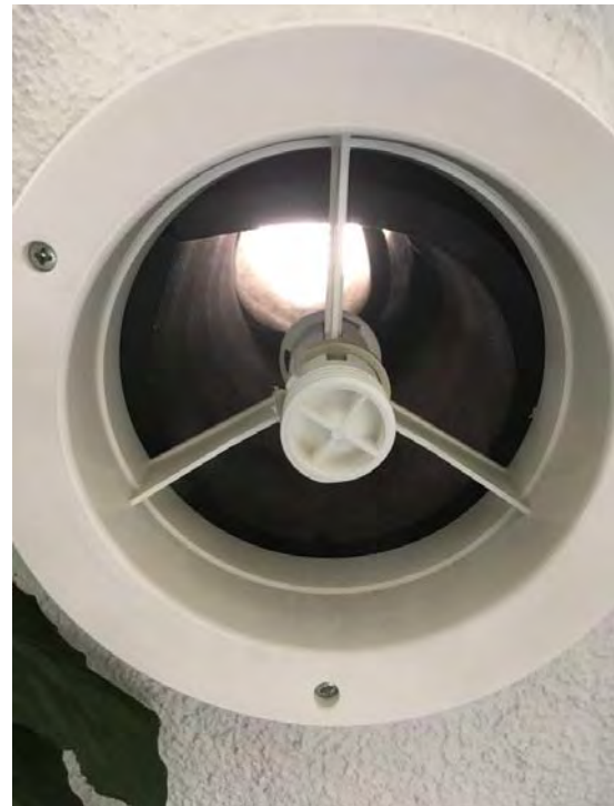
Abbildung 214: WNG ID 920: Zuluftkanal
