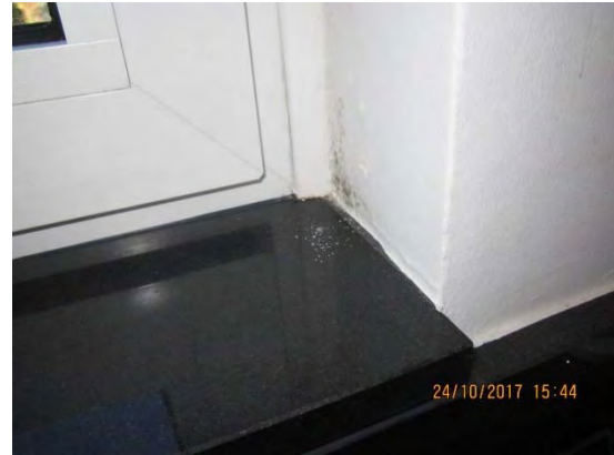
Abbildung 79: WNG ID 320: ev. Schimmelablagerung
