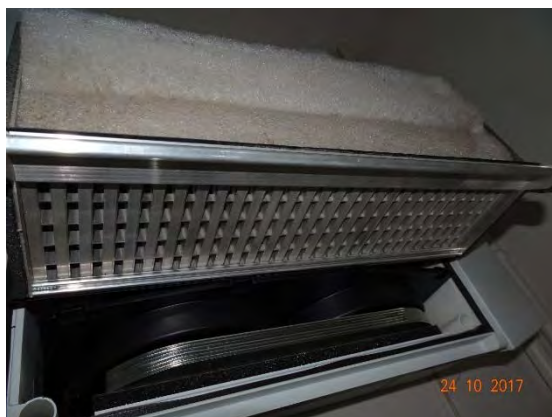
Abbildung 67: WNG ID 310: Wärmetauscher
