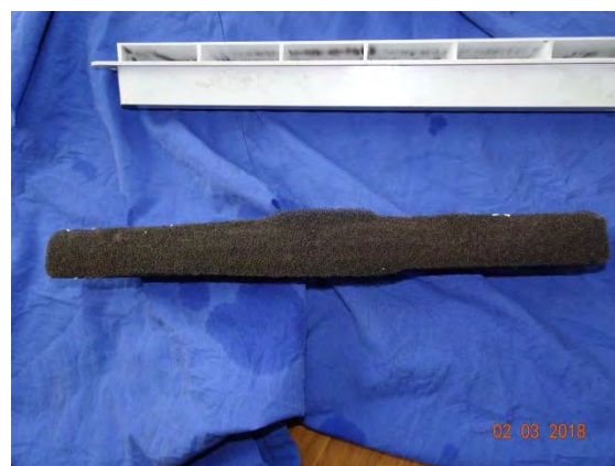
Abbildung 166: WNG ID 730: Zuluftfilter
