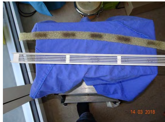
Abbildung 186: WNG ID 810: Zuluftfilter, Rückseite
