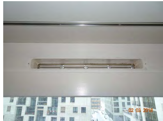
Abbildung 177: WNG ID 730: Durchbruch AUL v.I.
