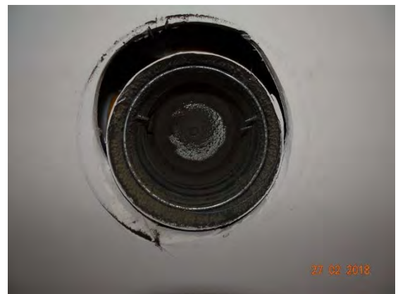
Abbildung 150: WNG ID 710: ABL-Rohr, Bad
