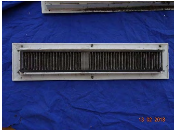
Abbildung 118: WNG ID 520: AUL-Filter, eingebaut
