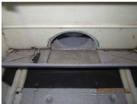
Abbildung 74: WNG ID 320: Lufteintritt in Gerät
