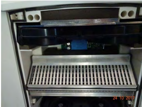
Abbildung 78: WNG ID 320: Wärmetauscher
