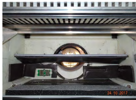
Abbildung 68: WNG ID 310: Lufteintritt in Gerät
