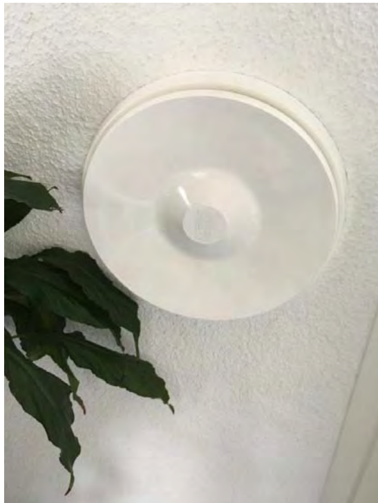
Abbildung 213: WNG ID 920: Zulufteintritt
