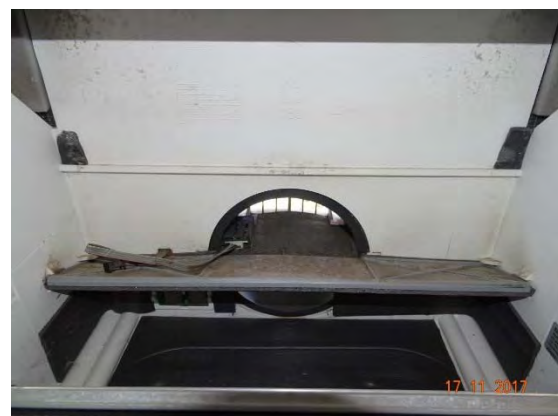
Abbildung 57: WNG ID 220: Lufteintritt in Gerät
