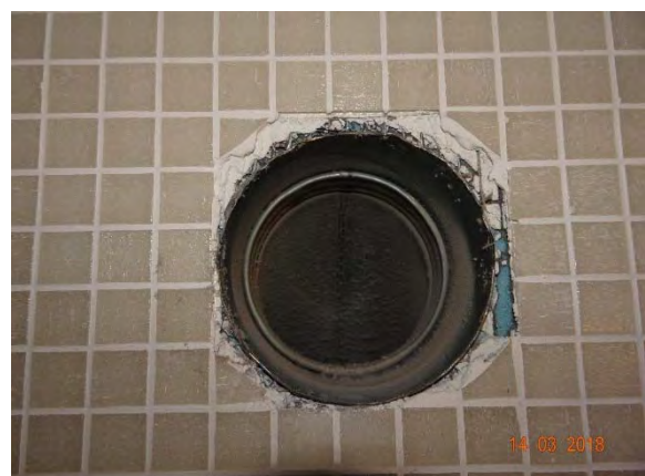
Abbildung 188: WNG ID 810: ABL-Rohr, Bad
