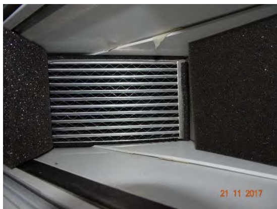
Abbildung 25: WNG ID 110: Wärmetauscher
