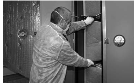
Les filtres doivent être régulièrement remplacés.
