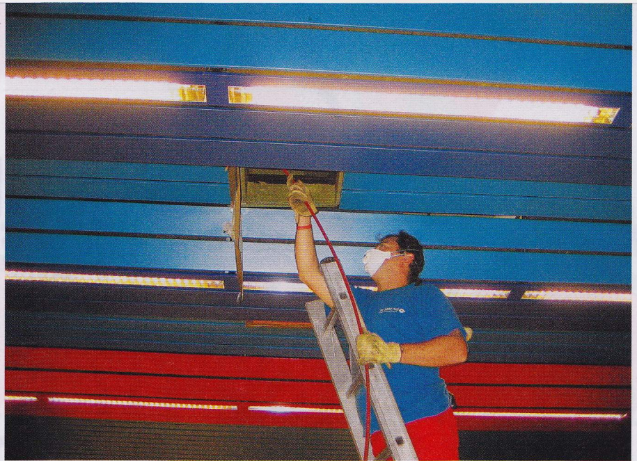
Experten untersuchten 100 raumluftechnische Anlagen: Sie prüften u.a. die Zugänglichkeit, die korrekte Montage und den hygienischen Zustand.
