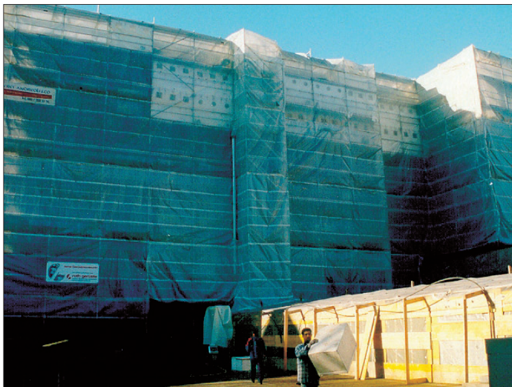
Die 35-jährige Gewerbliche Berufsschule in Chur wurde 2003 als erstes Gebäude in der Schweiz im Innen- wie auch im Aussenbereich PCB-saniert.
